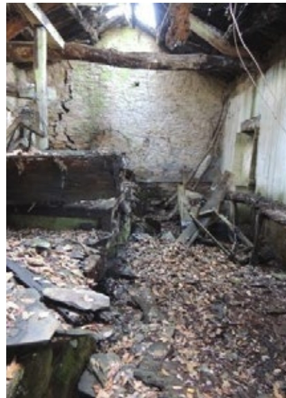
Fig.15 Interior en estado ruinoso
