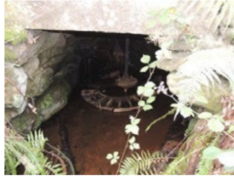
Fig. 17 Vista do rodicio co ferro desgastado
