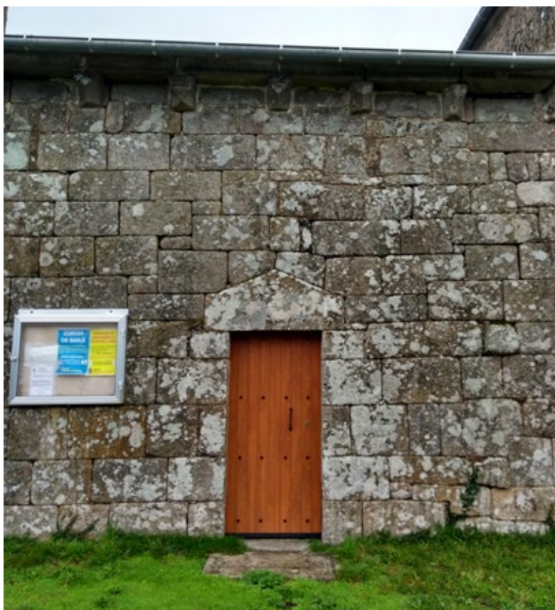
Fig. 51. Detalle dos canzorros e da portada sur de Prado, setembro 2017. (Arquivo fotográfico da autora).
