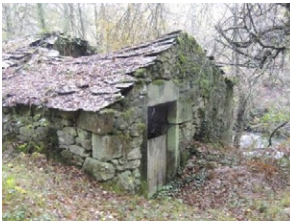
Fig.1 Detalle da fachada principal co teito fendido.
