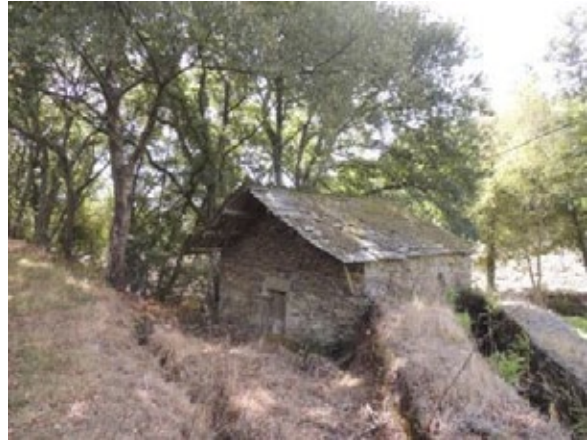
Fig. 33 Fachada principal con teitume frontal desproporcionado en proxección sobre a fachada
