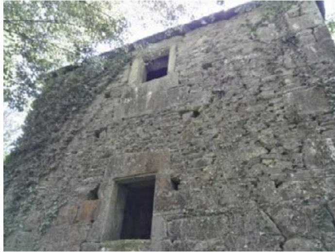
Fig. 26 Elevada verticalidade da fachada traseira
