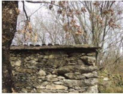
Fig 5. Detalle do bo estado de conservación do lousado do tellado
