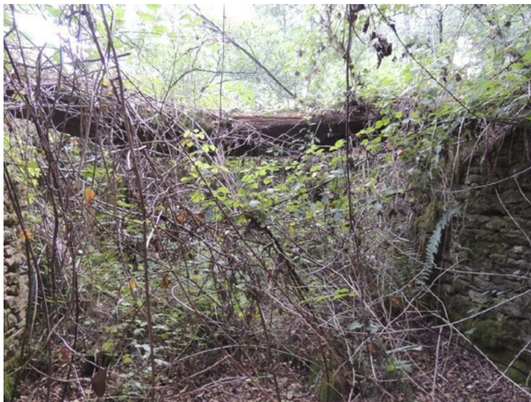
Fig. 58 Vista do interior con viga transversal pendurada do teito e invasión de maleza evidente
