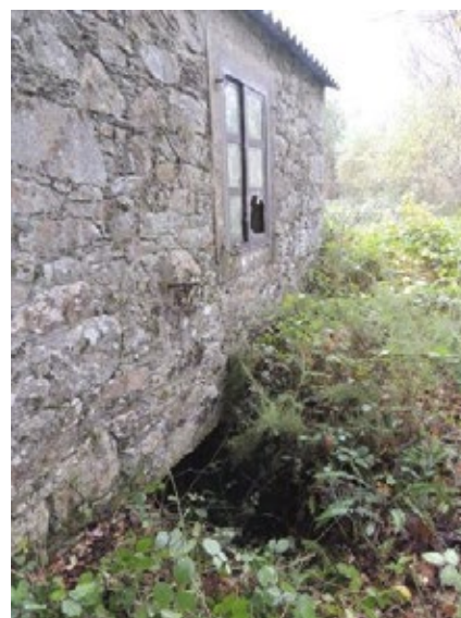
Fig.9 Detalle da xanela cos vidros rotos
