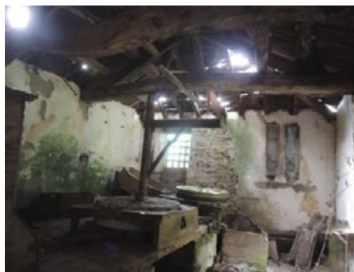
Fig.25 Teitume envellecido e ameazando ruina total
