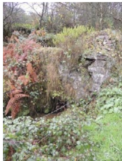
Fig. 68 Restos da estrutura perceptibles entre a maleza.
