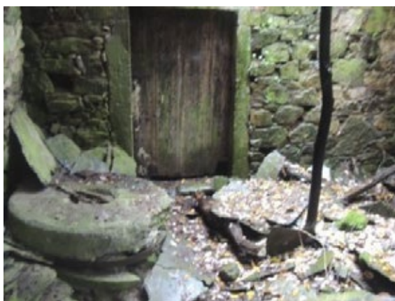
Fig. 3 Vista do acceso á entrada principal, observáse o deterioro e abandono
