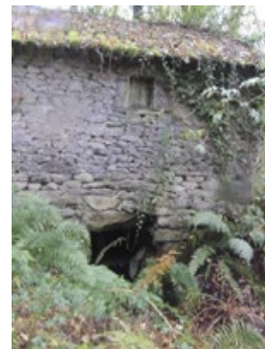
Fig. 2 Parte traseira para a canalización de entrada e saída da auga
