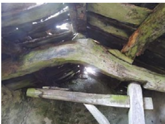
Fig. 17 Vista da podredume e deterioro do tellado que ameaza desprendemento e ruina.
